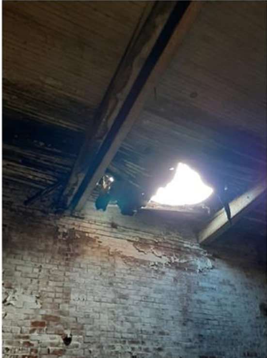
Trou toiture #5a Photo 2023 : Ville de Magog
