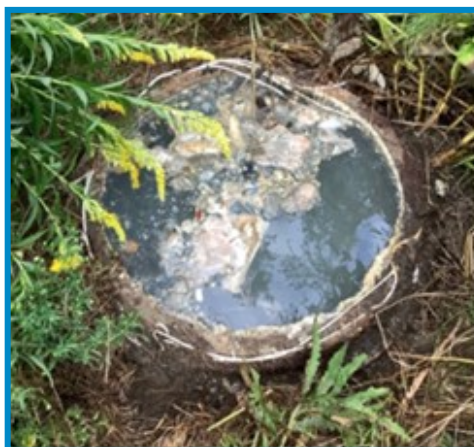
Fosse septique en débordement
