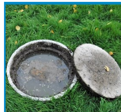
Fosse septique avec niveau d'eau élevé
