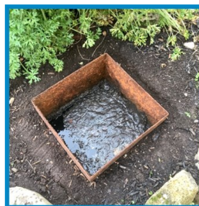
Fosse septique avec niveau d'eau élevé
